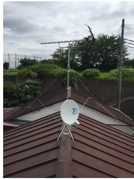
横浜市栄区笠間 地デジアンテナとBSアンテナ屋根上工事
