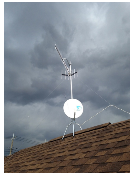
横浜市栄区元大橋 地デジアンテナとBSアンテナ屋根上工事
