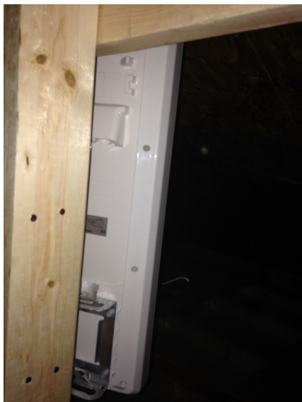
横浜市港南区丸山台 三井ホーム様物件 デザインアンテナ屋根裏工事
