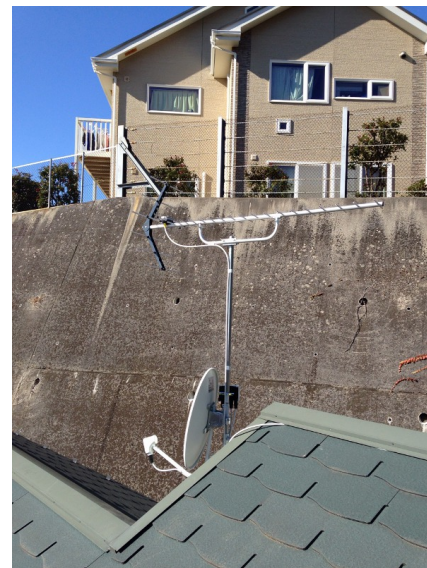
横浜市港北区日吉本町 壁面取付 地デジアンテナとBSアンテナ工事
