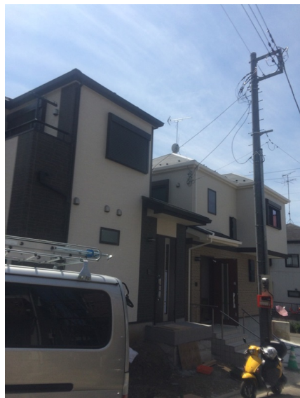
横浜市港北区篠原町 地デジアンテナとBSアンテナ屋根上工事
