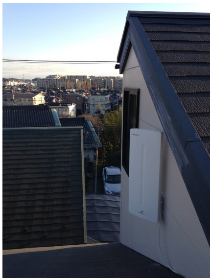
横浜市港北区新吉田東 壁面取付 デザインアンテナ工事
