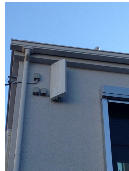
横浜市港北区大曽根台 壁面取付 デザインアンテナ工事
