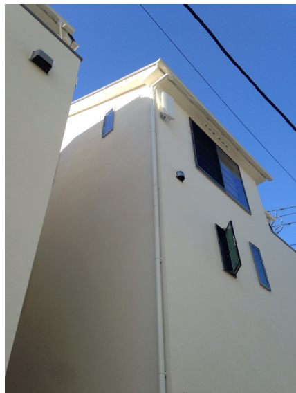
横浜市港北区高田東 デザインアンテナ工事後の 外観
