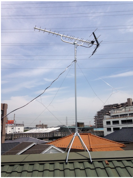
横浜市港北区樽町 積水ハウス様物件 地デジアンテナ屋根上工事
