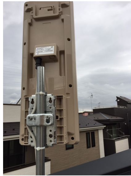
横浜市港北区樽町 オープンハウス様物件 壁面取付 デザインアンテナ工事
