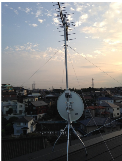
横浜市港北区篠原町 住友林業様物件 地デジアンテナとBSアンテナ屋根上工事
