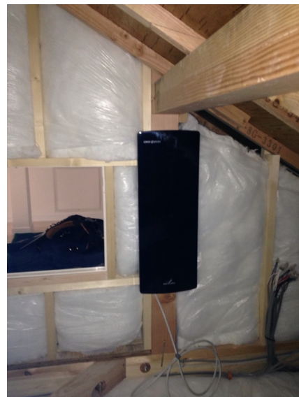
横浜市港北区大曽根 三栄建設様物件 デザインアンテナ屋根裏工事
