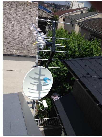
町田市南大谷 プリンシパルホーム様物件 壁面取付 地デジアンテナとBSアンテナ工事
