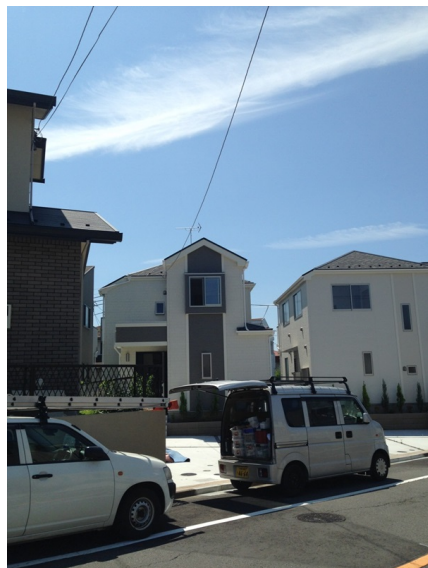
町田市能ヶ谷 サンケイホーム様物件 地デジアンテナとBSアンテナ工事後の外観
