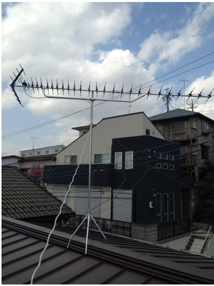
町田市玉川学園 山田建設様物件 地デジアンテナ屋根上工事
