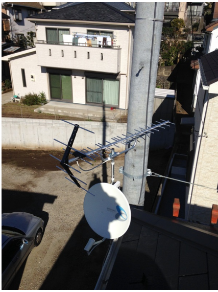
町田市成瀬 アサカワホーム様物件 壁面取付 地デジアンテナとBSアンテナ工事
