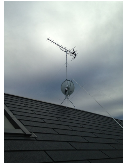
八王子市大塚 東栄住宅様物件 地デジアンテナとBSアンテナ屋根上工事
