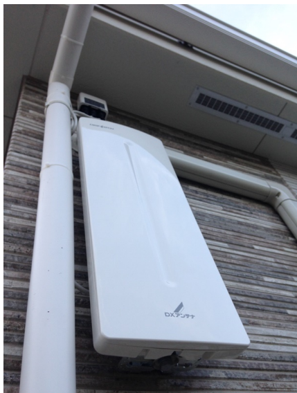
八王子市大塚 東亜建設様物件 壁面取付 デザインアンテナ工事
