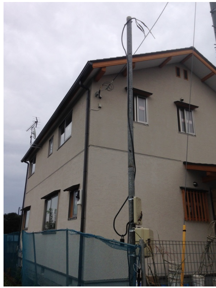
八王子市谷野町 四季工房様物件 地デジアンテナとBSアンテナ工事後の外観
