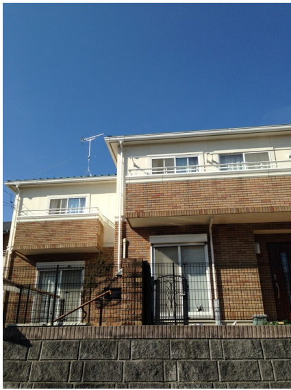
八王子市元八王子町 クレバリーホーム様物件 地デジアンテナ工事後の外観
