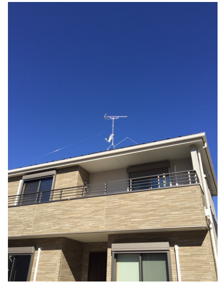
八王子市鎌水 東亜建設様物件 地デジアンテナとBSアンテナ工事後の外観
