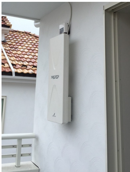
八王子市東中野 イーカム様物件 壁面取付 デザインアンテナ工事
