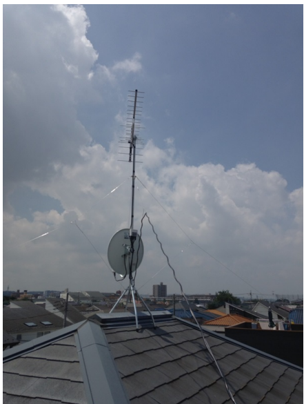
調布市布田 地デジアンテナとB S アンテナ屋根 上工事
