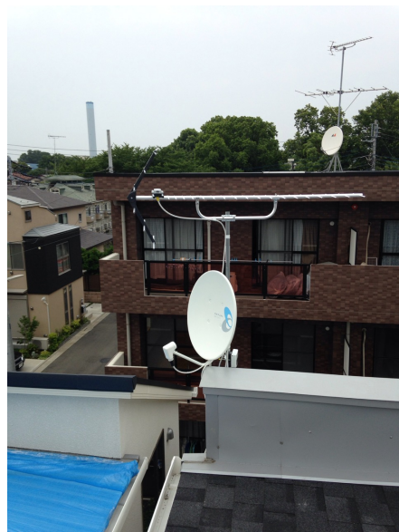
調布市深大寺東町 地デジアンテナとBSアンテナ 工事
