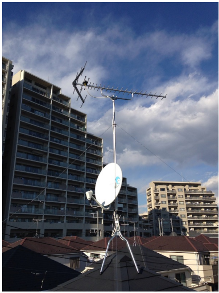
調布市上石原 地デジアンテナとBSアンテナ屋根上工事★ギャラリー
