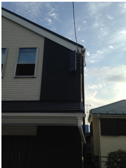
調布市入間町 八正建設様部建 地デジアンテナとBSアンテナ屋根上工事
