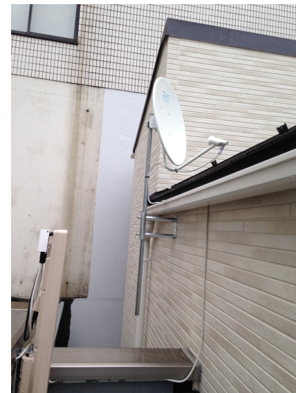
台東区小島 三栄建設様物件 壁面取付 BSアンテナ工事
