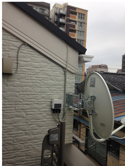
台東区根岸 東建ホームズ様物件 壁面取付 BSアンテナ工事
