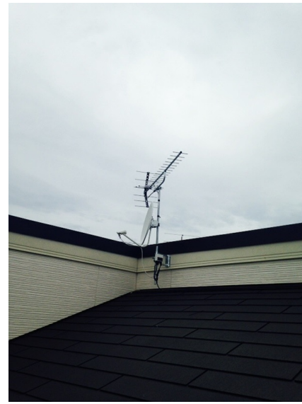
世田谷区船橋 東栄建設様物件 壁面取付 地デジアンテナとBSアンテナ工事
