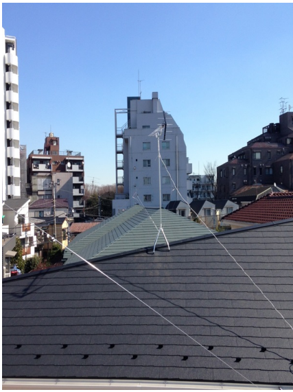
世田谷区下馬 ライフデザイン様物件 地デジアンテナ屋根上工事
