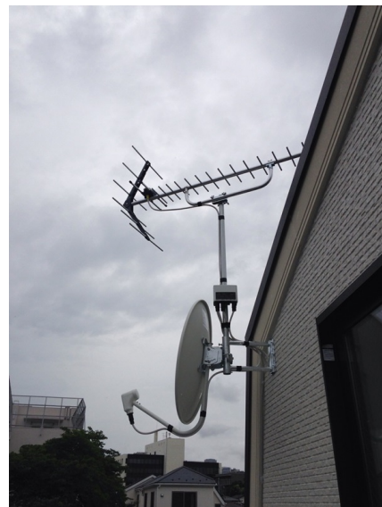
世田谷区玉堤 秀光建設様物件 壁面取付 地デジアンテナとBSアンテナ工事
