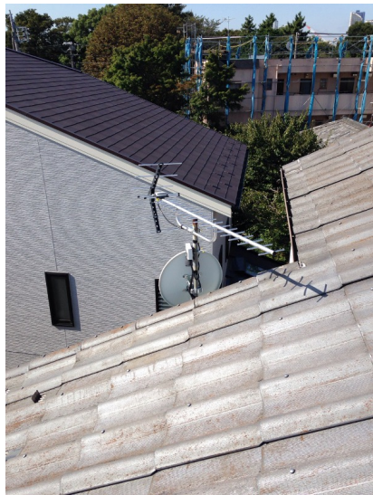
大田区南久が原 壁面取付 地デジアンテナとBSアンテナ工事後
