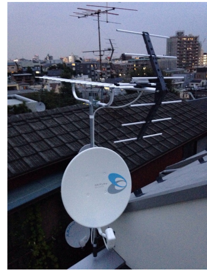
大田区西馬込 壁面取付 地デジアンテナとBSアンテナ工事
