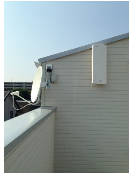
板橋区相生町 壁面取付 デザインアンテナとBSアンテナ工事
