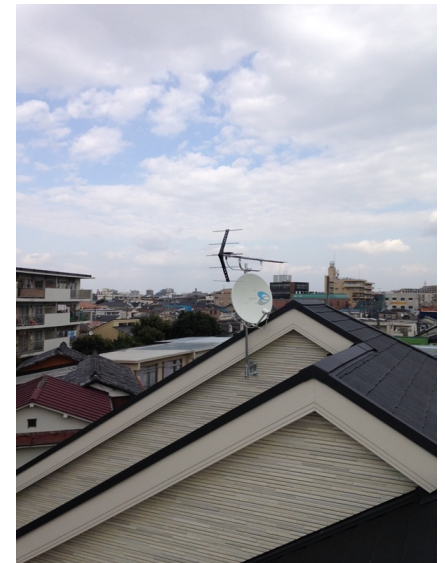
板橋区前野町 壁面取付 地デジアンテナとBSアンテナ工事
