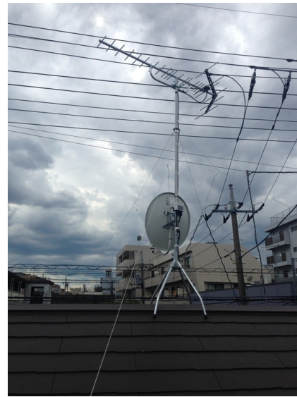
板橋区坂下 地デジアンテナとBSアンテナ屋根上工事
