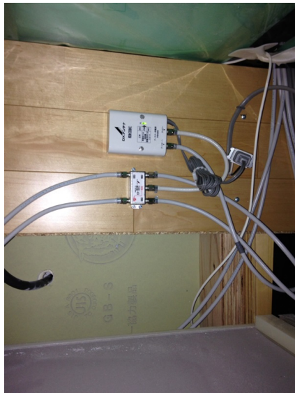
所沢市上新井 住協建設様物件 ブースター電源部 4分配器
