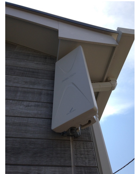
所沢市東所沢 住協建設様物件 壁面取付 デザインアンテナ工事
