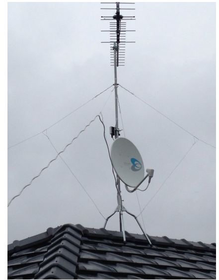
所沢市若狭 地デジアンテナとBSアンテナ屋根 上工事
