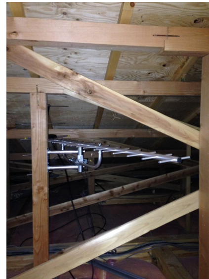
所沢市山口 山口企画設計様物件 地デジアンテナ屋根裏工事
