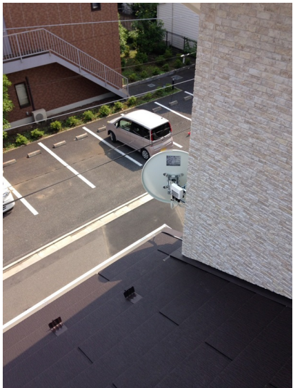
所沢市上新井 住協建設様物件 壁面取付 BSアンテナ工事
