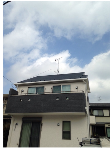
所沢市山口 山口企画設計様物件 地デジアンテナとBSアンテナ工事後の外観
