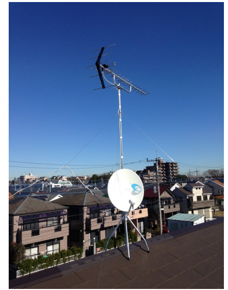
所沢市久米 山口企画設計様物件 地デジアンテナとBSアンテナ屋根上工事
