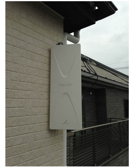
越谷市袋山 トータルエステート様物件 ブースター電源部 ブースター本体 4分配器
