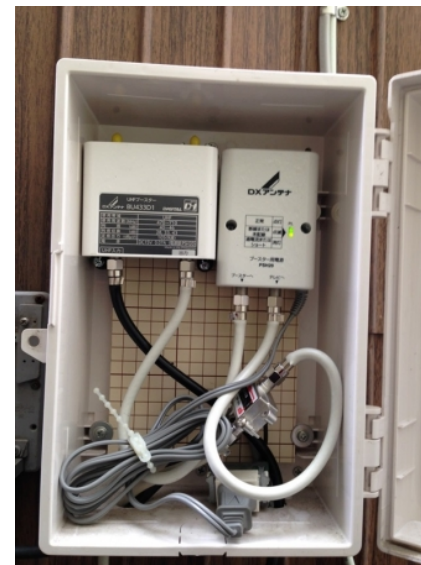
川口市芝下 大和不動産様物件 ブースター本体 ブースター電源部
