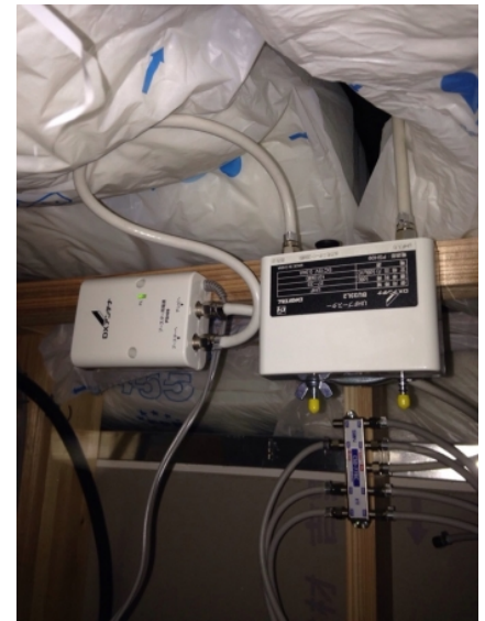
川口市江戸 城南建設様物件 8分配器 ブースター電源部 ブースター本体
