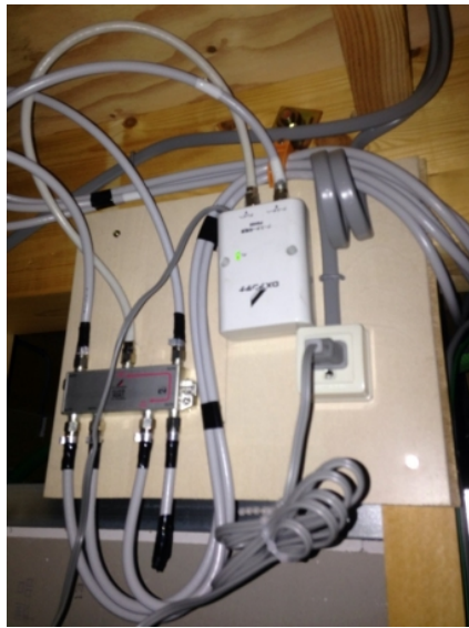
川口市榛松 6分配器 ブースター電源部
