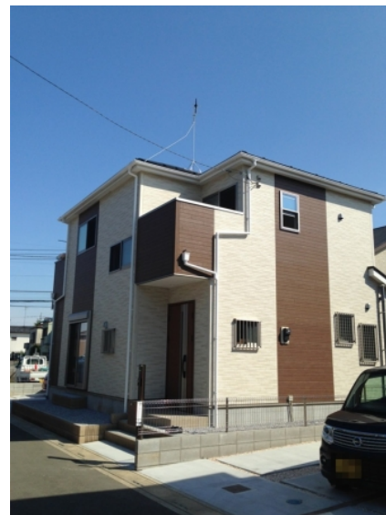
上尾市原市 アベルト様物件 地デジアンテナ工事後の外観
