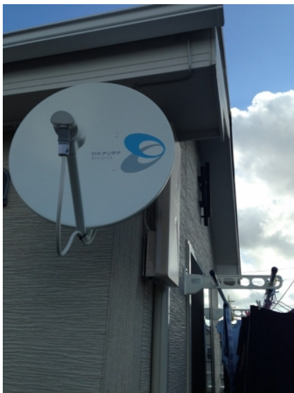
上尾市中新井 オリオン様物件 壁面取付 デザインアンテナとBSアンテナ工事
