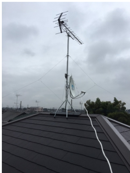
上尾市小泉 ミサワホーム様物件 地デジアンテナとBSアンテナ屋根上工事
