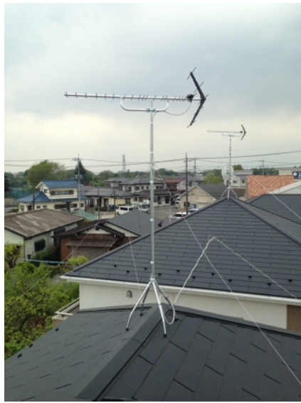
上尾市小敷谷 コガネイハウジング様物件 地デジアンテナ屋根上工事
