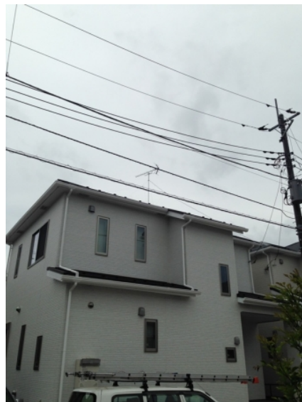
上尾市瓦葺 昭栄建設様物件 地デジアンテナ工事後の外観
