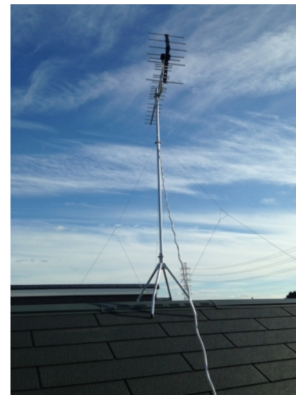
上尾市平塚 城南建設様物件 地デジアンテナ屋根上工事
