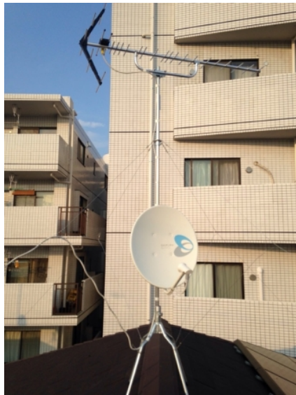
上尾市上尾村 ダイワハウス様物件 地デジアンテナとBSアンテナ屋根上工事
