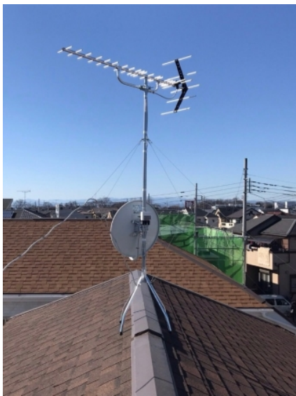
上尾市小泉 サンシティホーム様物件 地デジアンテナとBSアンテナ屋根上工事
