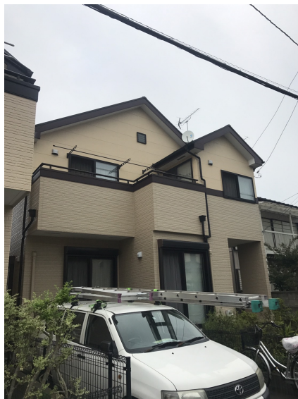
上尾市瓦葺 地デジアンテナとBSアンテナ工事後の外観
